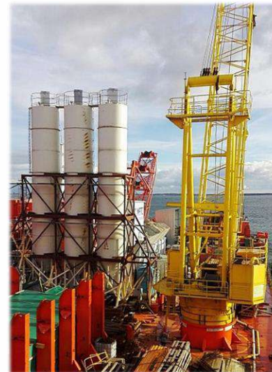
Общий вид размещения силосов РБУ на ТУБ «МРТС Дефендер»
